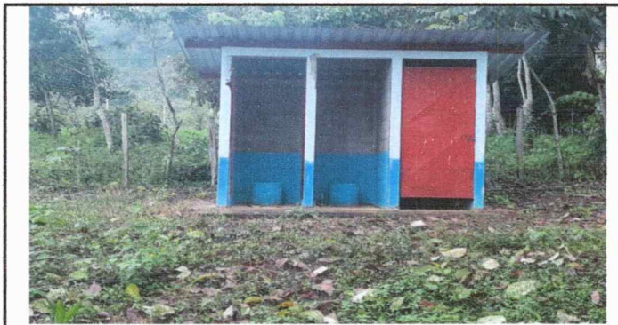
Foto 3: Los sanitarios requieren la colocacion de nuevas puertas
